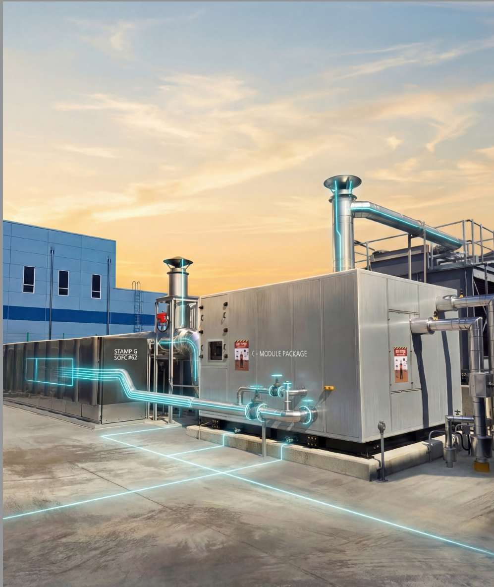
燃料電池排熱回収冷却システム (SKエコプラント)
